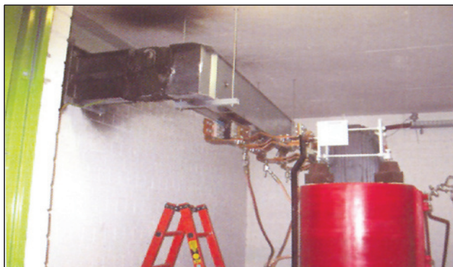
شکل ۱۷ (الف): ترانسفورماتور خشک با ارتباطات
