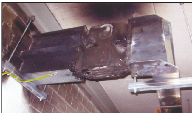
شکل ۱۷ (ب): اتصال کوتاه در کابل
